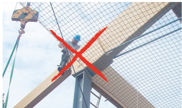
6 Wirkungsloses Auffangnetz mit ungenügendem Überstand zur Absturzkante
