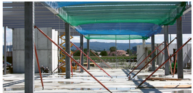
1 Mit Auffangnetzen lassen sich Personenabstürze ins Innere des Bauwerks verhindern.
